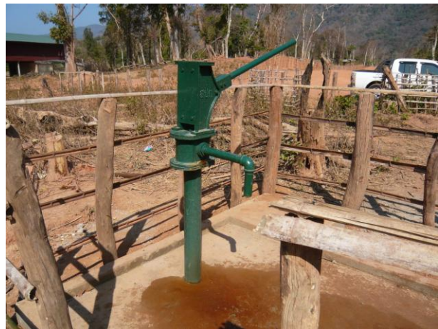
La pompe manuelle installée à Lang Khang. Jean Louis Charlot(ESF) a bien voulu « réceptionner » pour nous les travaux lors de sa récente mission en février 2011.
